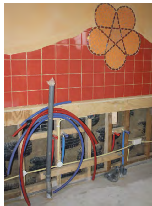
Met leem afgewerkte wanden. Bewoners maken zich de woning eigen door een grote diversiteit in afwerkingen, zoals hier boven het toekomstige keukenblok.
