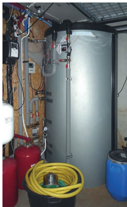
△ In de Sailer Schichtenspeicher wordt op verschillende temperatuurniveaus voor verschillende functies warmte onttrokken, waarbij wordt voorkomen dat de vloerverwarming de warmte voor het sanitair 'op maakt'.
